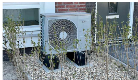
Bron afbeelding: Bouweninstallatiehub
